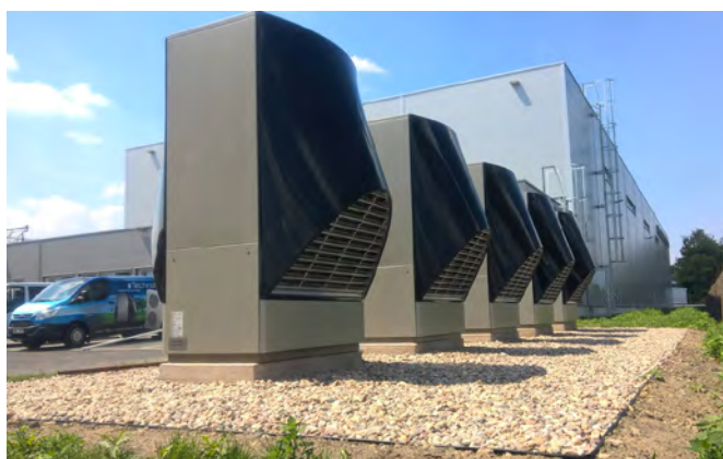
Průmyslová hala, venkovní systém vzduch/voda
